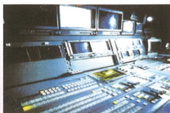
▲ 閉路電視電腦台
