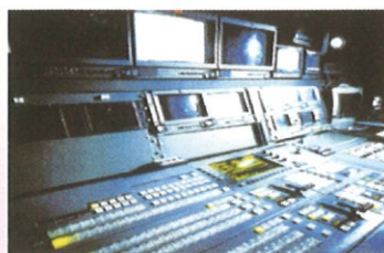
▲ 閉路電視電腦台
